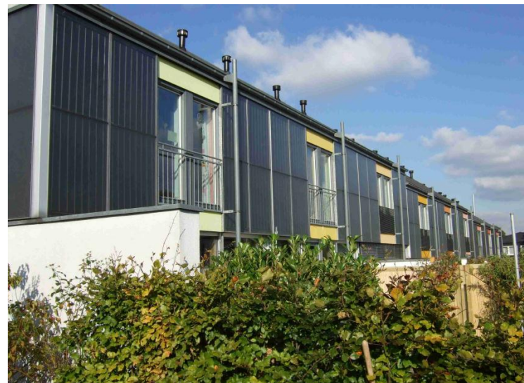
壁面設置の集熱器
